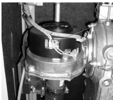
Кабель питания модулирующего вентилятора
